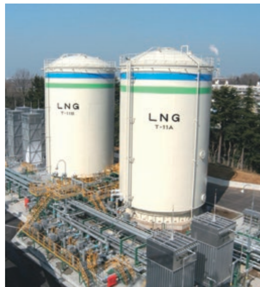
LNG卫星站储罐(TYPE304)
